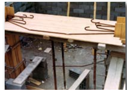
Verschalung der Säulen und Betonplatte, auf welcher später das Hauptinstrument platziert wurde.
